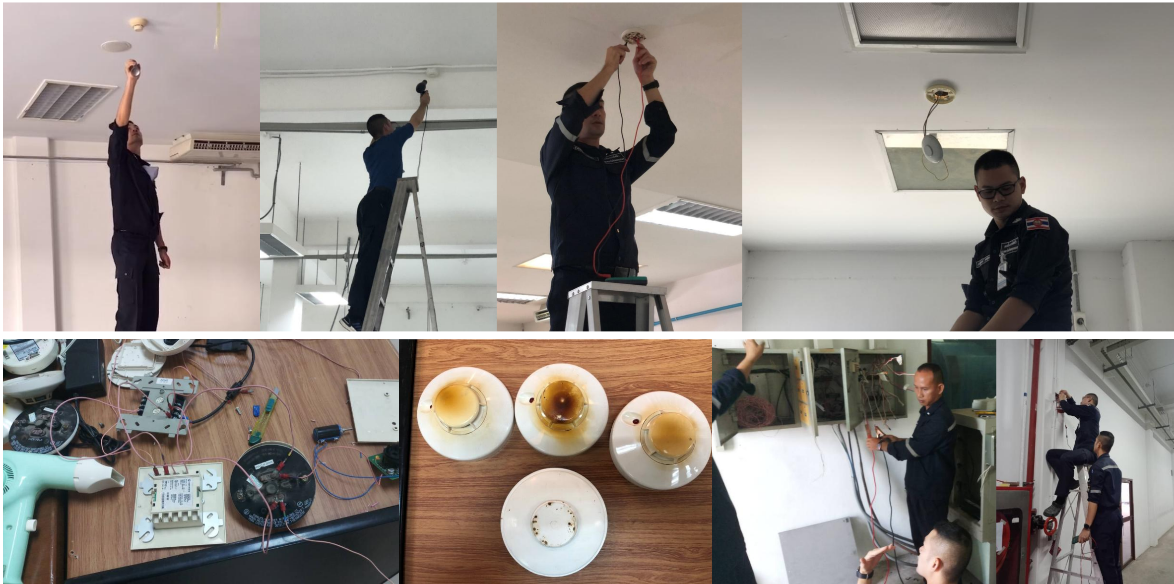
รูป ตรวจสอบการทำงานของอุปกรณ์ทั้งหมดของระบบฯเดิม
